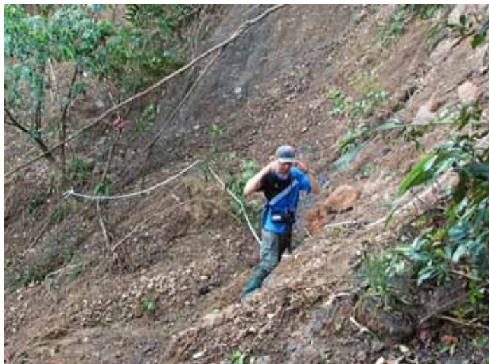
圖 9. 88 風災後南仁山生態保護區步道路基流失, 必須靠索道通過滑落的山坡。
