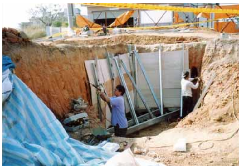
圖 12. 基礎封裝及斷面兩側掏空（一）。
