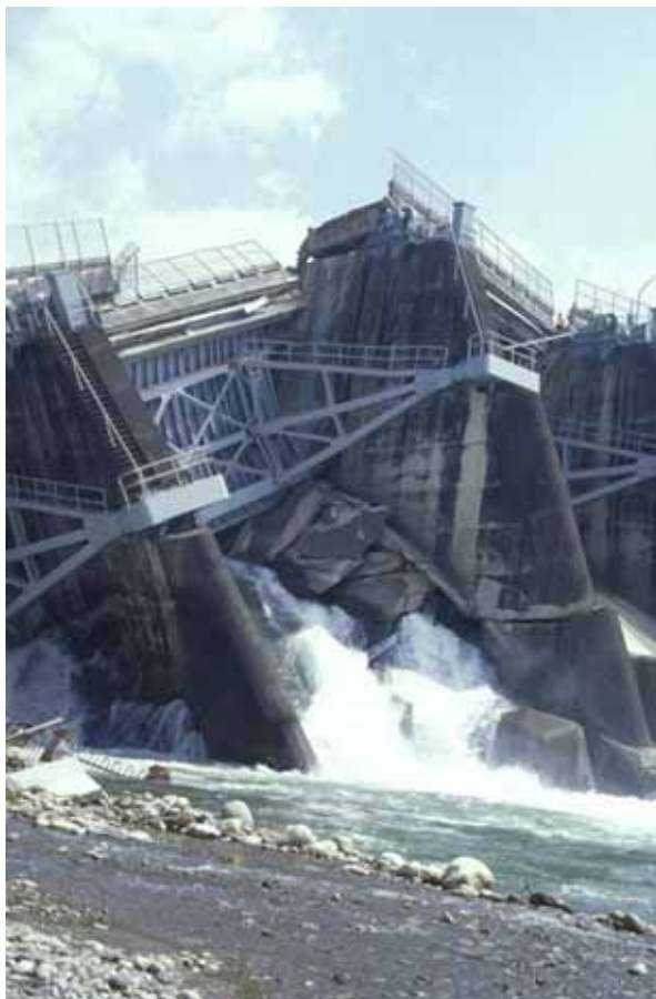
圖 2. 921 地震地表破裂切過石岡壩，造成北側閘門嚴重破壞。南側抬升 9 公尺，北側 2 公尺，兩側高低落差達 7 公尺，致使壩體斷裂毀壞。
