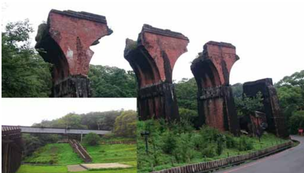
圖 5. 1935 年新竹臺中地震震毀的魚藤坪斷橋 (即龍騰斷橋)，第四座橋墩上部為 1999 年 921 大地震時震毀崩落。左下圖為當時震後所建立的鐵橋。
