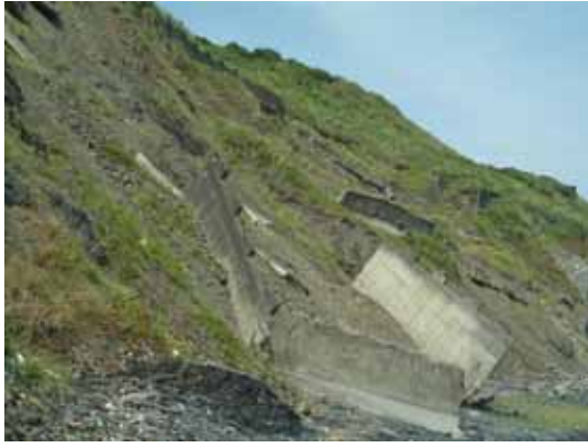
圖 30. 蘇澳岳明新村澳仔角-北方澳間於 2009 年颱風，海岸線公路邊坡護牆崩塌毀損造成道路交通中斷。
