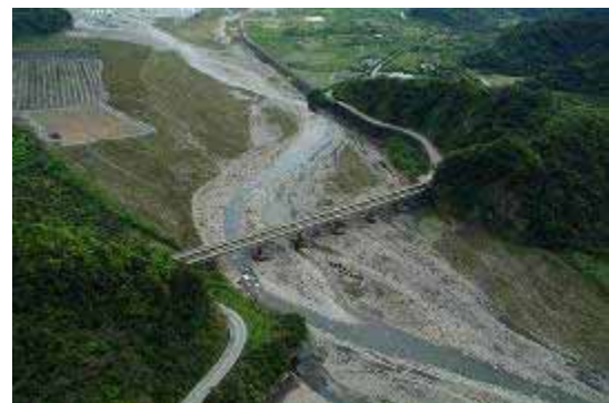
圖 10. 蘭陽溪牛鬥橋，橋墩已裸露，若繼續開採河川砂石將危及道路橋樑與河堤以及村莊部落安全。
