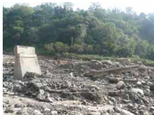
圖 4. 莫拉克颱風八八水災毀壞之綠茂橋。
