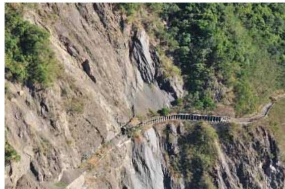
圖 14. 明隧道局部放大特寫鏡頭，沿線所經主要為劈理發育岩石易破碎的樟山層硬頁岩地層。
