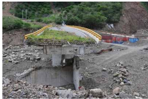
圖 12. 桃源區塔羅留溪新翠谷橋，於八八風災過後緊急搶修情況。
