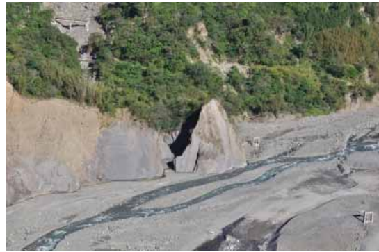
圖 28. 少年溪風景區近況鳥瞰圖。少年溪及頽圯的少年溪吊橋橋墩。
