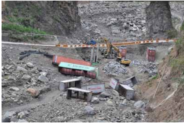
圖 7. 埔頭溪荖荖溫泉（高中溫泉）入口 處災後搶修現況。
