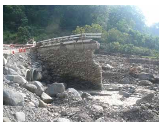
圖 6. 莫拉克颱風時毀壞之南橫公路炳才橋及搶修後通車之臨時便道。
