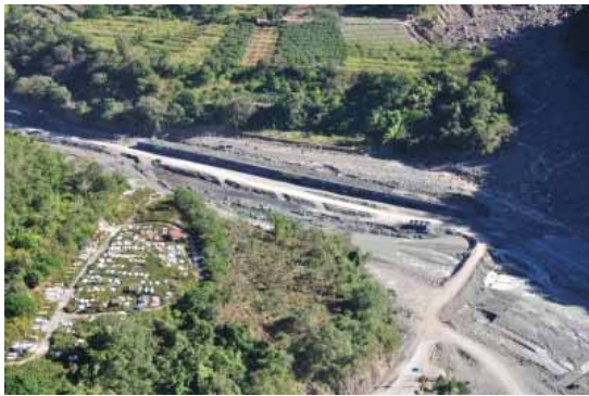
圖 23. 桃源區樂農橋鄰近河岸高灘地墓園及其附近荖濃溪道整治及道路搶修之概況。
