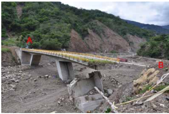
圖 11. 桃源區塔羅留溪新翠谷橋，八八水災橋斷路毀。A 為塔羅留溪護溪步道鮎魚保護區地標；B 為硬頁岩地層中出露的冷泉碳酸鹽岩露頭。
