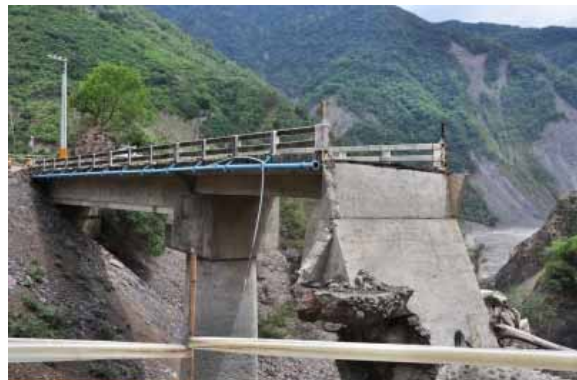
圖 18. 桃源區舊社萬年橋，八八水災橋斷路毀之現況。
